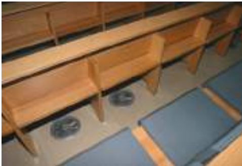
As condutas de ar condicionado no piso técnico (subterrâneo) desembocam em grelhas no pavimento da assembleia e do altar
