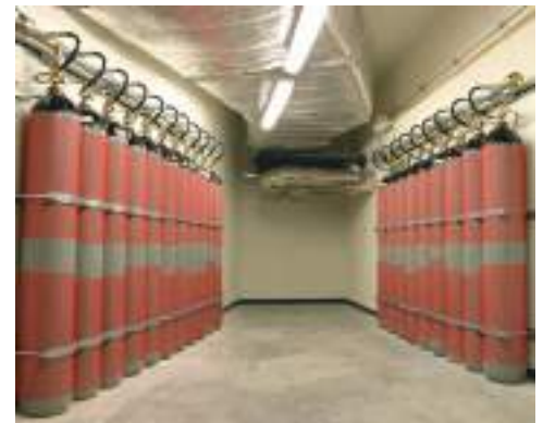
A sala do gerador é um dos espaços cuja extinção de incêndio é feita por nitrogénio. Com este método inovador, perante o incidente um conjunto de garrafas despeja o nitrogénio até determinada percentagem do espaço mantendo o ar respirável
