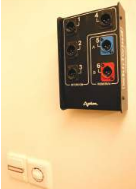
Uma das muitas caixas de ligação espalhadas pelo edifício e fornecidas pela Audium para as comunicações técnicas na rede infra-estruturada por cabo. Por baixo, vemos os interruptores de iluminação controlados por E.I.B. e ainda reguladores de volume que equipam várias salas do edifício
