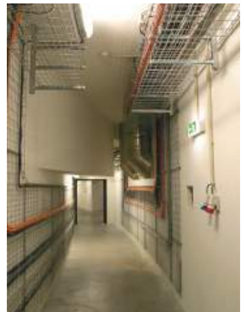
Os corredores técnicos percorrem todo o edifício circular e estão preparados com esteiras para a passagem de cabos dos meios de comunicação social ou outras entidades
